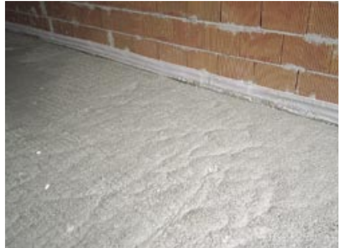
Povrch penobetónu s degradovanou štruktúrou
